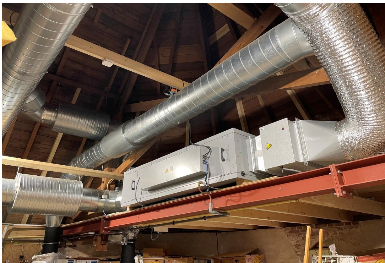
Boven de kleine zaal de techniekruimte. De WTW unit op plateau met de steunbalk.
